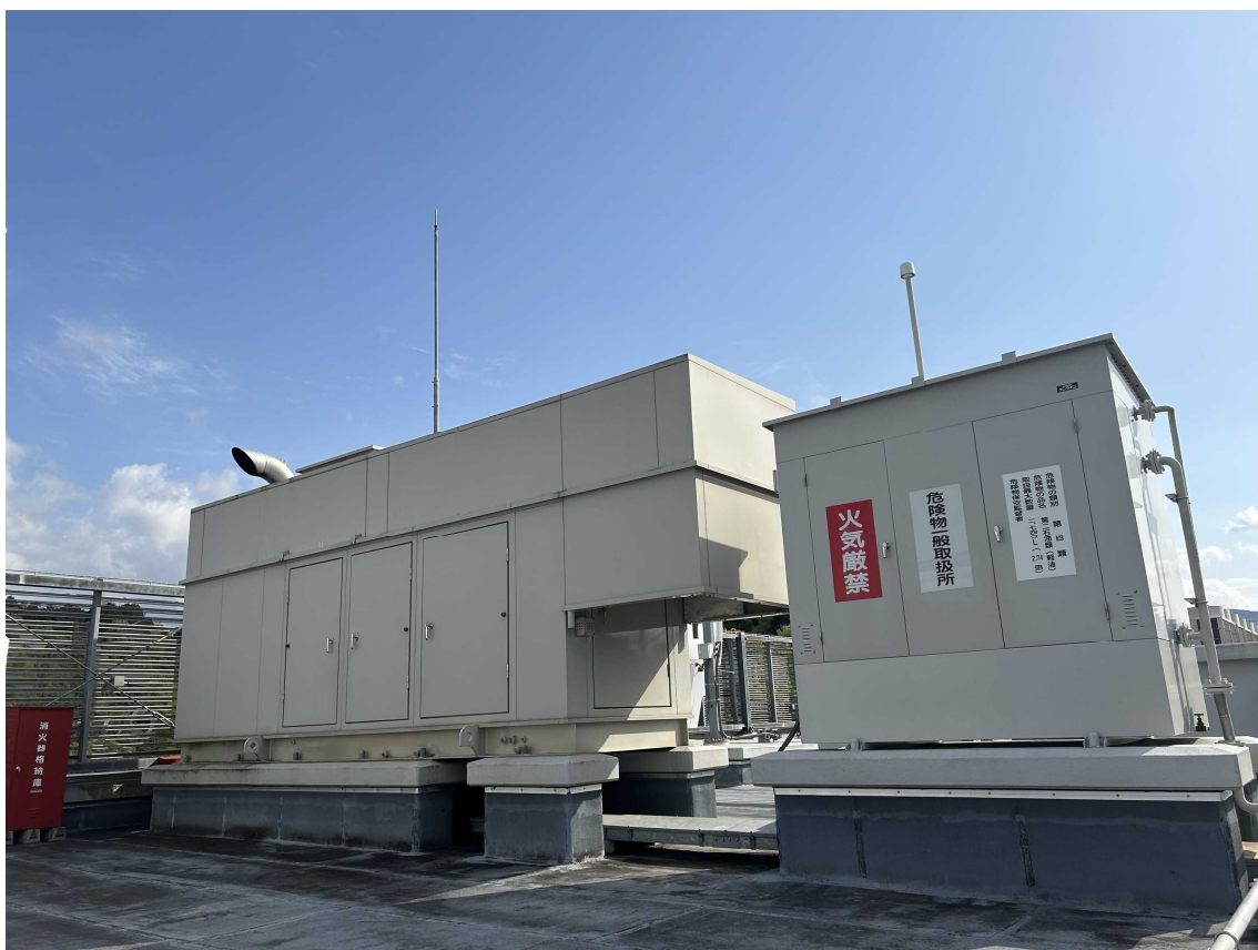
危険物施設 一般取扱所（発電設備）
